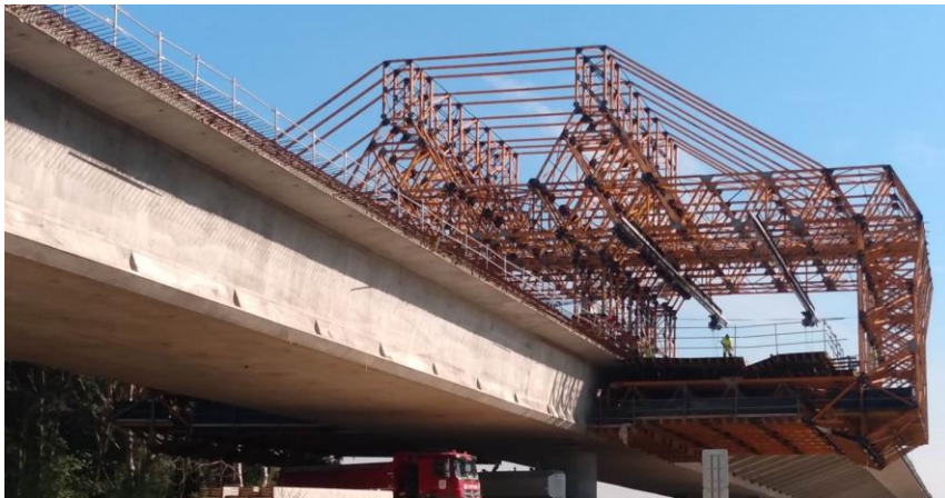
Obr. 52 Betonážny vozík, ktorý slúži na dobetónovanie konzol priečného rezu v alternatíve C, pohľad zdola (Lužný most, Bratislava, 2019)
