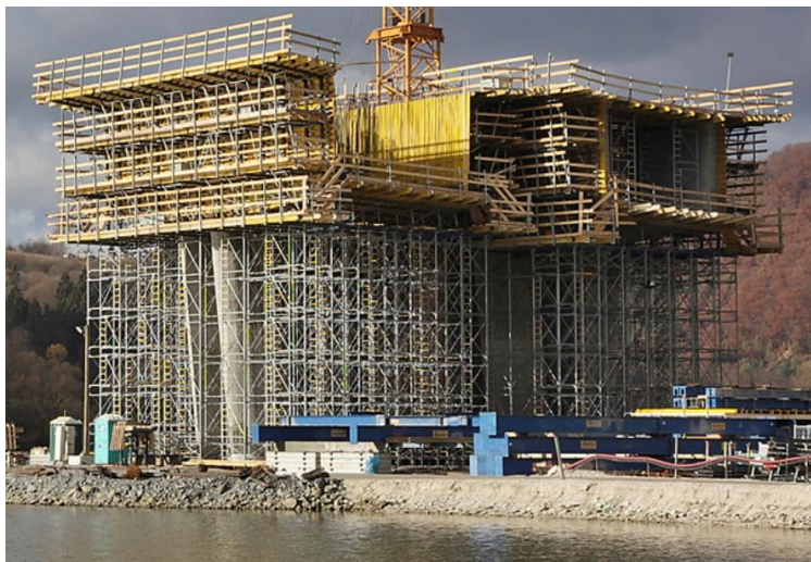
Obr. 85 Výstavba zárodku so skružou podopretou na základe piliera. Most cez vodnú nádrž Hričov, 2016.
