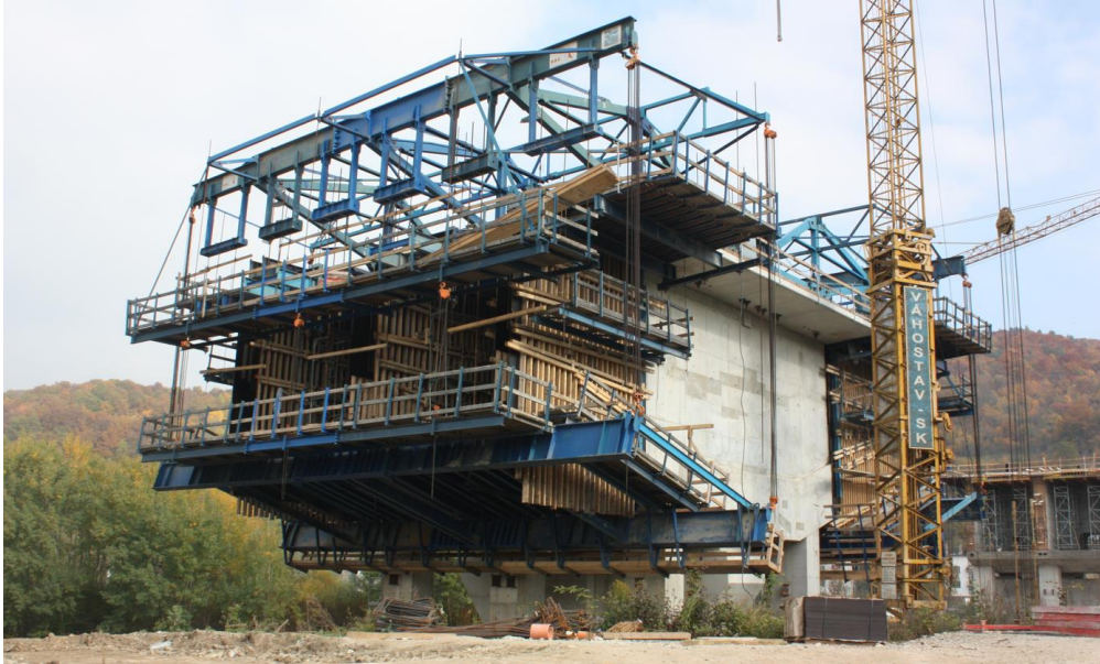
Obr. 98 Pohľad na betonážne vozíky pri stavbe dvojkomorového prierezu železničného mosta cez Nosickú priehradu, 2017.
