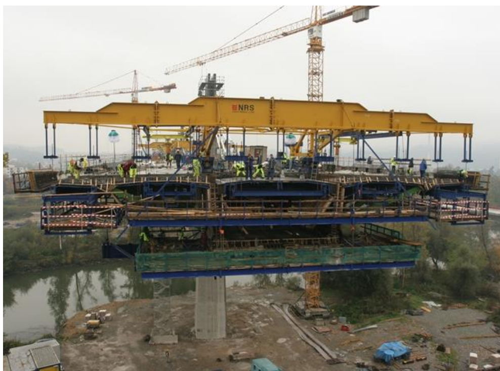
Obr. 48 Jednoetapová letmá betonáž prierezu pre plný diaľničný profil (most v Považskej Bystrici, 2009)
