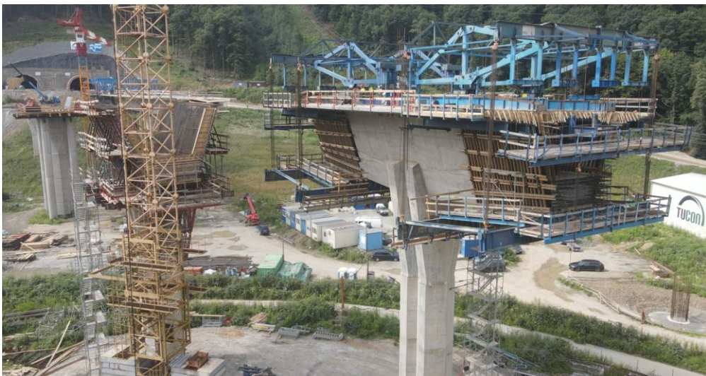
Obr. 97 Pohľad na betonážne vozíky pri stavbe prvých lamiel. Stabilita vahadla je zabezpečená rámovým spojením hornej a spodnej stavby. Vľavo, za žeriavom čiastočne vidieť debnenie pre zárodok betónovaný v dvoch fázach (výstavba mostov na stavbe diaľnice D1 na obchvate Prešova, 2021).
