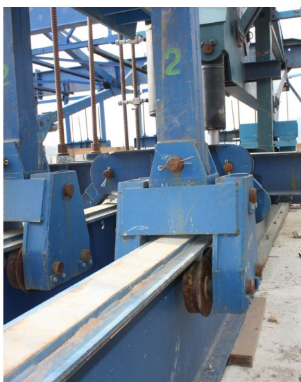
Obr. 93 Ocelové kolieska stabilizujúce betonážny vozík o hlavné koľajnice počas presunu do novej polohy.
