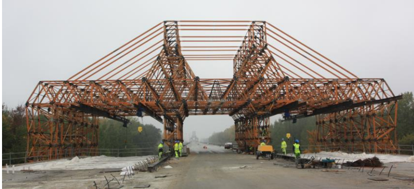
Obr. 51 Betonážny vozík, ktorý slúži na dobetónovanie konzol priečného rezu v alternatíve C, pohľad z mostovky (Lužný most, Bratislava, 2019)
