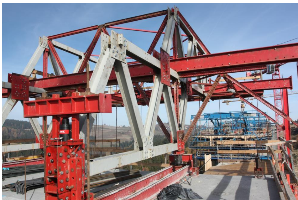
Obr. 94 Zadné kotvenie vozíka (vľavo). V prednej časti vozíka je vidieť čierny zvislý hydraulický valec medzi hlavnými koľajnicami (Most Valy, 2015).
