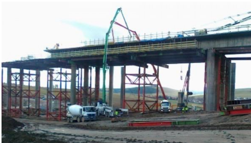
Foto z betonáže - pár hodín pred zrútením skruže (2.11.2012). ((web))
