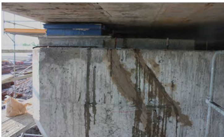
Obr. 39: Porušená hlavica piliera vysúvaného mosta po sanácii trhlín.
