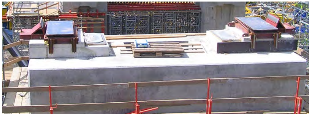
Obr. 82: Klzné ložiská a bočné vedenie na pilieri. Most v Považskej Bystrici.
