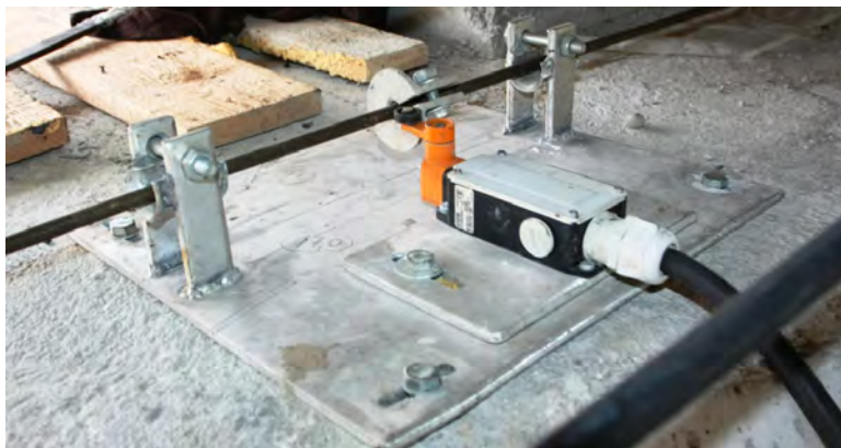
Obr. 90: Oceľové lano, zarážka a spínač, ktorý vypne výsun v prípade prekročenia povolenej deformácie piliera
