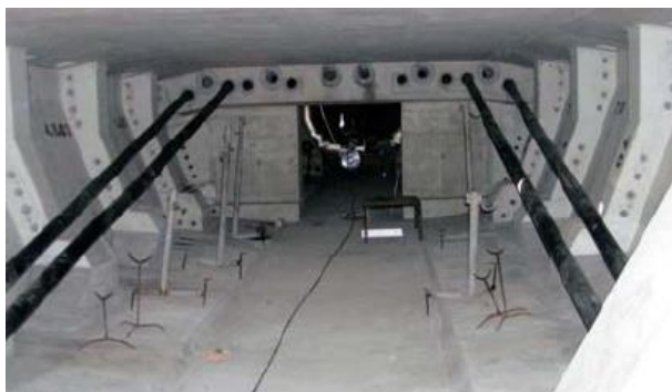
Obr. 45 Voľne vedené káble, pohľad do vnútra komory.
