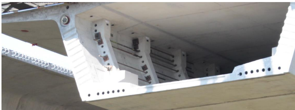
Obr. 79 Pripnutie segmentov o hotovú časť konštrukcie predpínacími tyčami v rámci montážnych rebier segmentov – pozri aj obr. 36.
