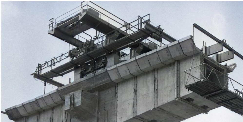
Obr. 68 Posuvný zdvíhací rám s priečnou konzolou na podvesenie a presun segmentu pod mostom do montážnej pozície (most pri Margecanoch, kolorizované, 1966, foto: TASR).
