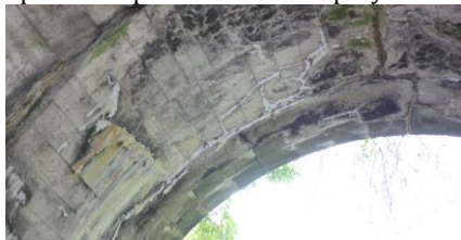
Obr. 2 Inkrustované trhliny v ostení pri portáloch tunela
