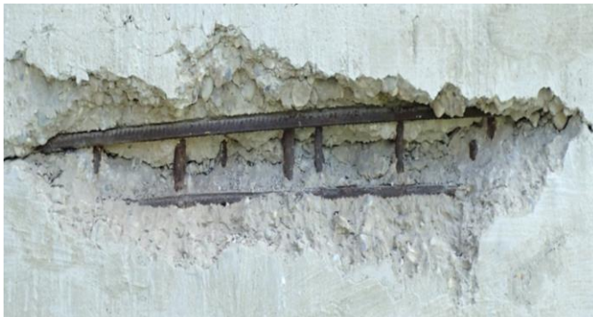
Obr. 1 Kaverna v pracovnej škáre na vonkajšom povrchu steny sila
