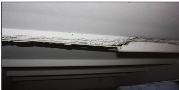
Obr. 7 Delaminácia krycej vrstvy rebierok na strešnom paneli
