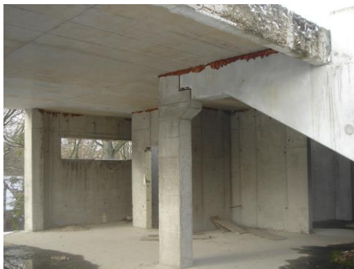
Obr. 4 Časť monolitického prekladu s chýbajúcou krycou vrstvou
