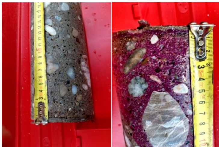
Obr. 1: Omietka na betóne opory objektu SO-02.2 spomaľujúca karbonatizáciu
