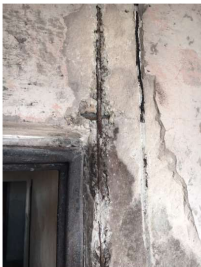
Obrázok 5: Odhalená výstuž v ostení a nadpraží dverného otvoru bytu č. 48 na 11. poschodí
