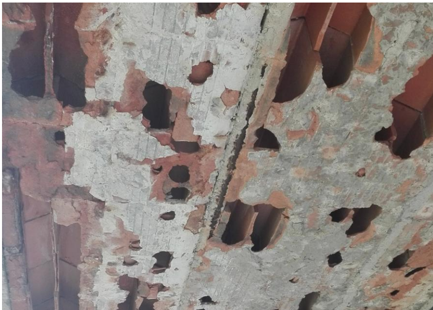
Obr. 7 Porušený dolný povrch balkónov – keramické panely
