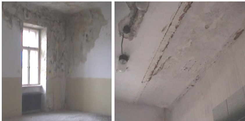
Obr. 1 Zavlhnuté muriva a korodujúce ocelové I nosníky v budove na prízemí
