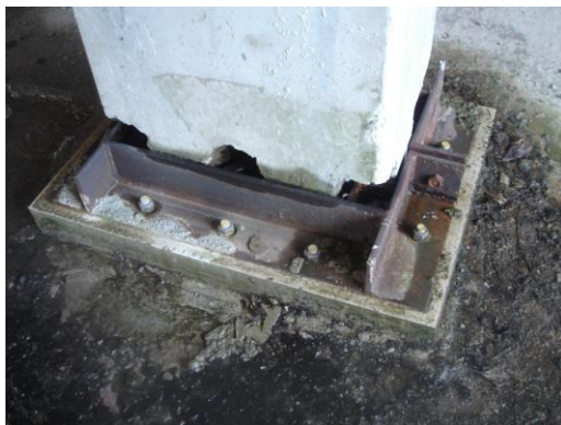
Obr. 6 Detail nesprávneho kotvenia stĺpov
