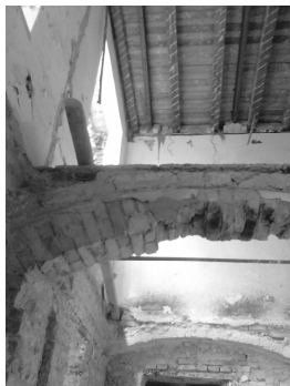
obr. 3 Poškodená klenba - uličné krídlo
