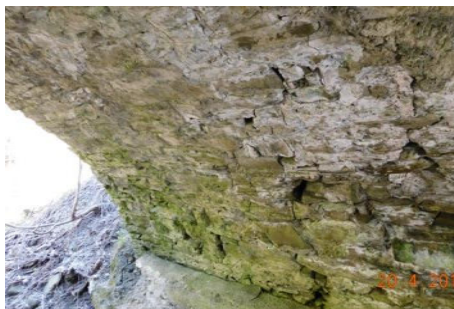
b) Trhliny v kamennej klenbe
