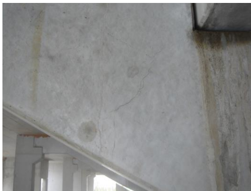
Obr. 5 Trhliny na tribúnovom prefabrikáte na 2.NP
