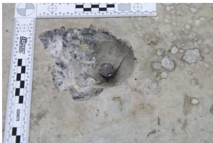
Obr. 3 Detail odsekání panelu v místě kotvy. Stržená hlava kotvy po vyvléknutí ze zdvihacího oka
