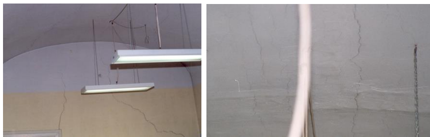
Obr. 4 Trhliny v murive priečky a klenbe
