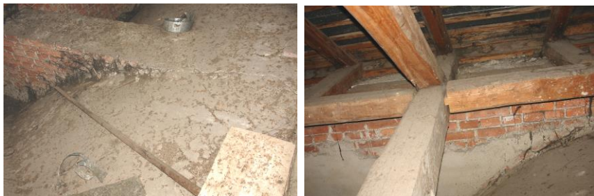
Obrázok 1 – Viditeľné trhliny na styku oblúka a klenby kostola a nedokonalé väzby pomurnice
