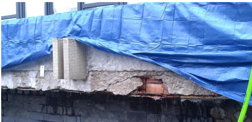
Obr. 9 Zaťažovacia skúška výrazne porušeného poľa balkónov
