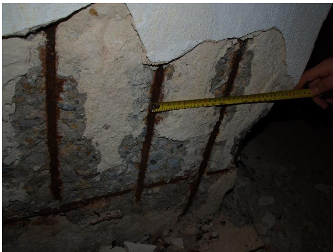
Obr. 3 Odpadnutá krycia vrstva betónu a korózia výstuže v päte steny
