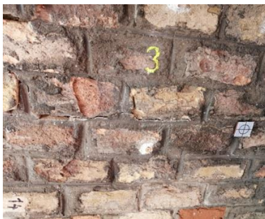
a) Trhlina v murovanej klenbe
