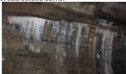
Obr. 4 Inkrustovaná horizontálna trhlina
