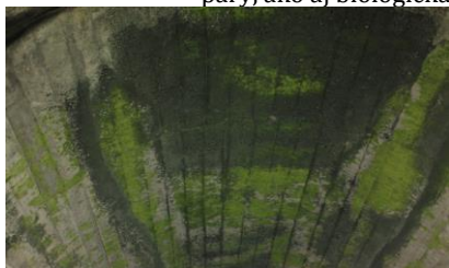
Obr. 3 Biologická korózia betónu ostenia
