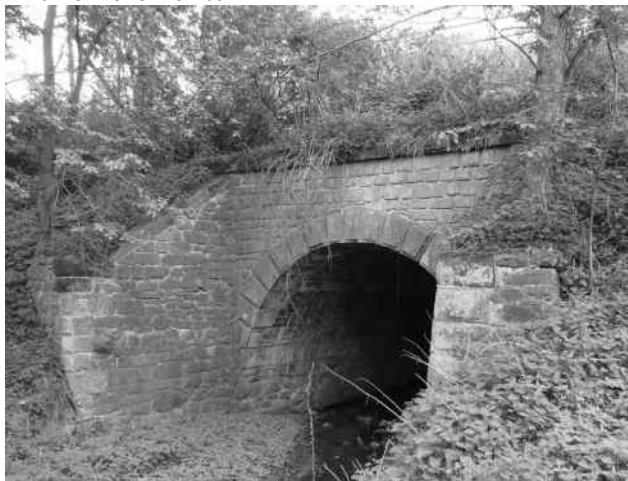
Obr.1 Klenba s vysokým nadnásypom (SO 12-19-12, km 21,745)
