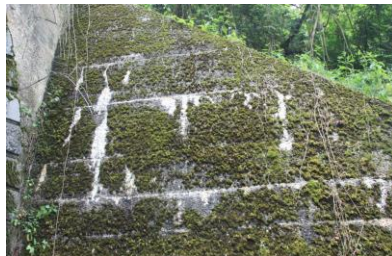
Obr. 6 Celoplošná biologická korózia betónu krídel portálov
