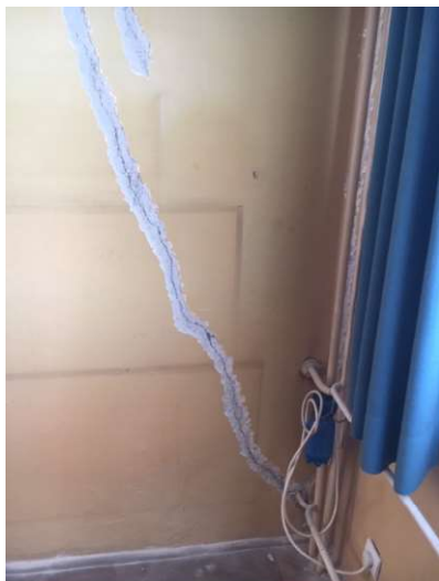
Obrázok 3: Pohľad na trhlinu v stene na 11. poschodí zo strany bytu č. 47
