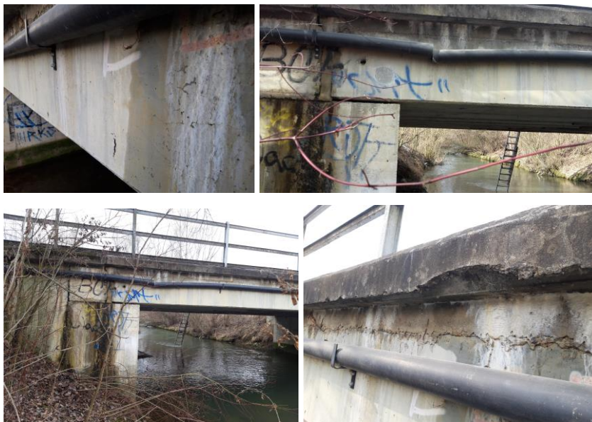
Obr. 2 Pohľad z bočnej strany na mostný objekt a na opory – zatekanie chloridov
